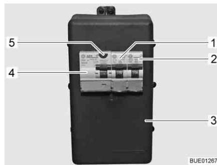
Billede 173 230 V-sikringskabinet med sikkerhedsafbrydere og HFI-afbrydere
