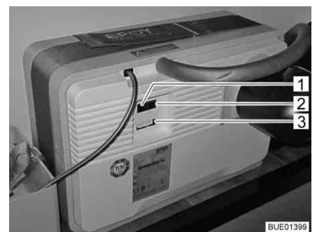
Fig. 169 Champ de raccordement de la pile à combustible
