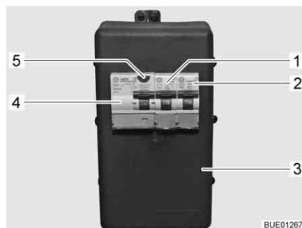
Fig. 173 Coffret de fusibles 230 V avec disjoncteur de protection de circuit et disjoncteur FI
