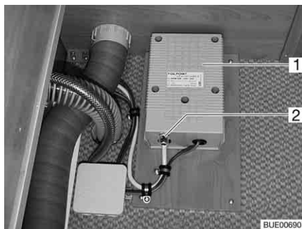
Fig. 205 Transformador para o aquecimento elétrico do chão
