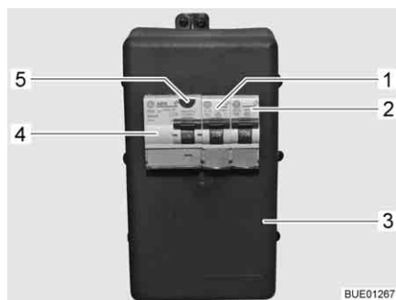
Fig. 184 Caixa de fusíveis de 230 V com disjuntor automático e disjuntor DR
