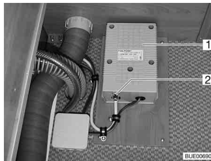
Bild 169 Transformator för elektrisk golvvärme
