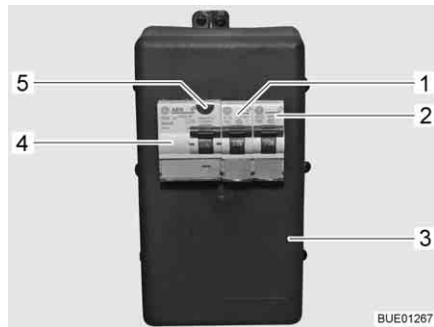
Bild 176 230 V-säkringslåda med ledningsskyddsbrytare och FI-brytare
