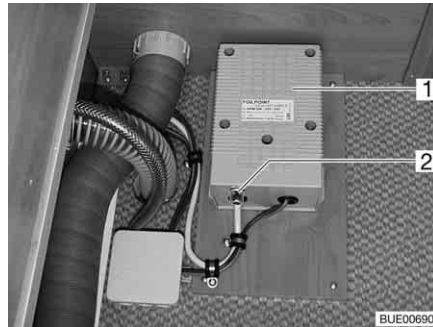
Bild 199 Transformator för elektrisk golvvärme
