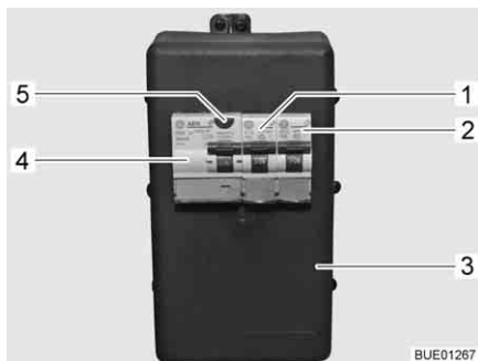
Bild 165 230 V-säkringslåda med ledningsskydds brytare och FI-brytare
