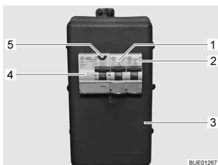
Afb. 89 230-V-zekeringenkast met beveiligingsautomaat en FI-schakelaar
