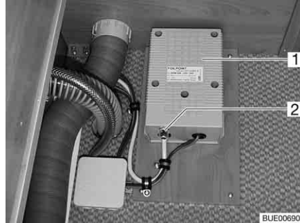
Afb. 108 Transformator voor de elektrische vloerverwarming
