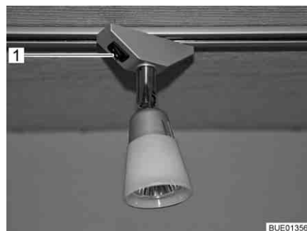
Afb. 41 Spotlight, lichtschakelaar direct bij de lamp
