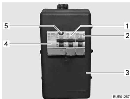
Bild 96 230 V-säkringslåda med ledningsskyddsbrytare och FI-brytare
