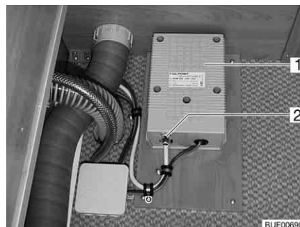
Fig. 211 Transformador para calentamiento eléctrico del piso
