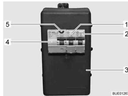
Fig. 189 Scatola dei fusibili a 230 V con interruttore di sicurezza e interruttore automatico FI
