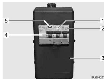
Fig. 123 Scatola dei fusibili a 230 V con interruttore di sicurezza e interruttore automatico FI
