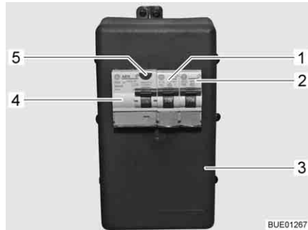
Afb. 123 230-V-zekeringenkast met beveiligingsautomaat en FI-schakelaar
