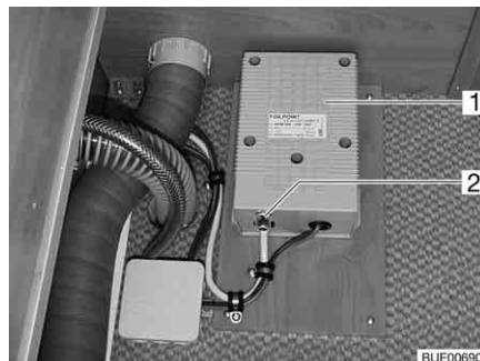
Billede 168 Transformator for elektrisk gulvopvarmning
