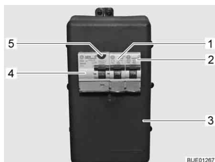
Billede 146 230 V-sikringskab med sikkerhedsafbryder og HFI-afbrydere
