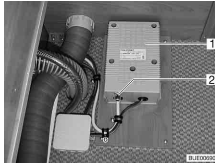
Kuva 186 Sähköisen lattialämmityksen muuntaja
