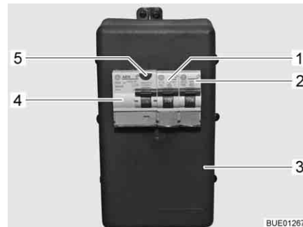
Billede 167 230 V-sikringsskab med sikkerhedsafbryder og HFI-afbrydere
