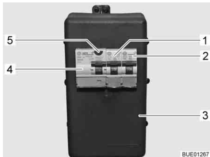
Kuva 152 230 V:n sulakerasia ja johdinsuojakytkin sekä FI-kytkin
