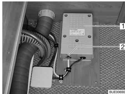
Kuva 173 Sähköisen lattialämmityksen muuntaja
