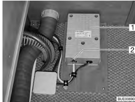
Billede 137 Transformator for elektrisk gulvopvarmning
