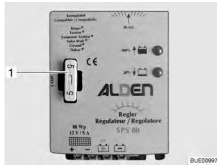
Billede 115 Sikring solar-laderegulator
