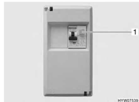
Fig. 117 Coffret de fusibles 230 V avec disjoncteur de protection de circuit et différentiel (disjoncteur FI)
