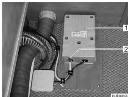
Fig. 137 Transformateur du chauffage électrique du plancher
