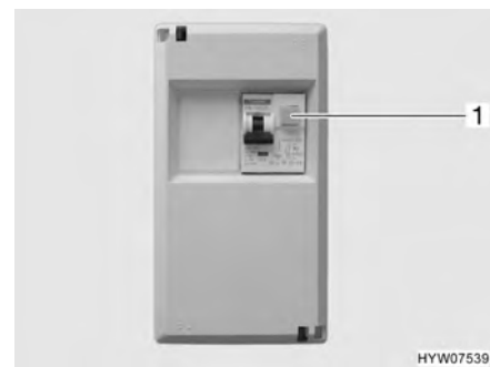
Afb. 117 230-V-zekeringenkast met leiding- en aardlekschakelaar (FI)
