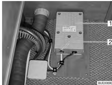
Afb. 137 Transformator voor de elektrische vloerverwarming
