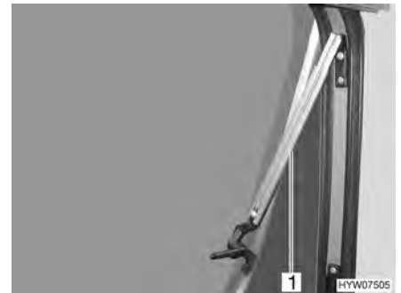
Kuva 67 Avattavat ikkunat, joissa on automaattipidikkeet
