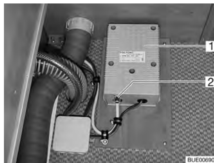
Billede 144 Transformator for elektrisk gulvopvarmning
