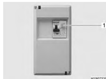
Billede 123 230 V-sikringseskab med lednings- og fejlstrømsrelæ (FI)
