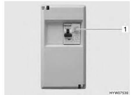
Billede 146 230 V-sikringskab med lednings- og fejlstrømsrelæ (FI)
