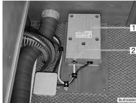
Billede 166 Transformator for elektrisk gulvopvarmning
