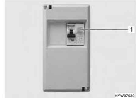
Bild 146 230 V-säkringslåda med lednings- och jordfelsbrytare (FI)
