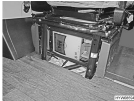
Kuva 49 230 V:n sulakerasian asennuspaikka
