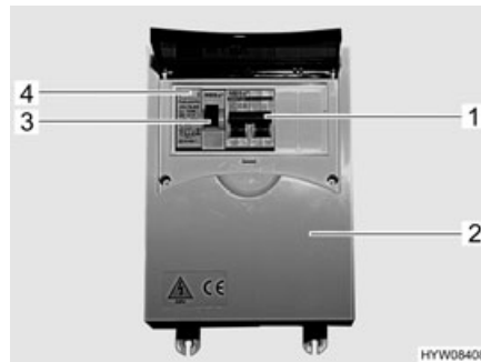
Kuva 43 230 V:n sulakerasia ja johdinsuojakytkin sekä FI-kytkin
