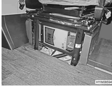
Bilde 49 Monteringssted 230-V-sikringsboks
