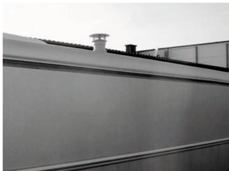
Fig. 85: Chimenea de gases de escape de la calefacción a gas
