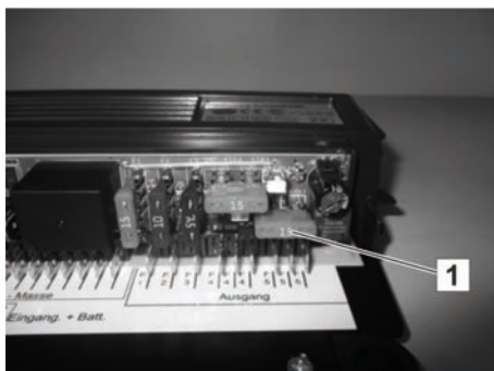
Fig. 64: Iluminación de emergencia de 12 V-
