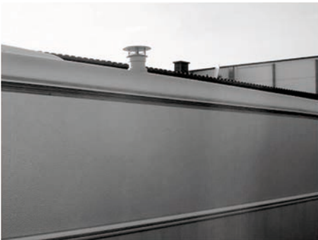
Afb. 85: Schoorsteen voor verbrandingsgassen van de gasverwarming
