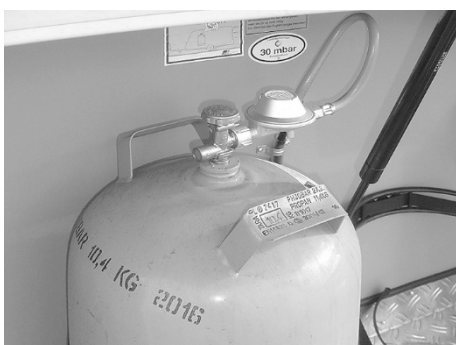
Fig. 103: Gasflaske med trykreduktionsventil
