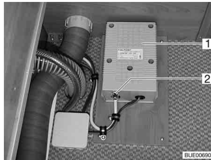
Fig. 169 Trasformatore per riscaldamento elettrico del pavimento
