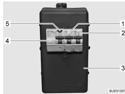
Fig. 139 Scatola dei fusibili a 230 V con interruttore di sicurezza e interruttore automatico FI
