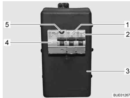
Fig. 139 Coffret de fusibles 230 V avec disjoncteur de protection de circuit et disjoncteur FI
