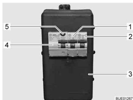
Fig. 148 Coffret de fusibles 230 V avec disjoncteur de protection de circuit et disjoncteur FI
