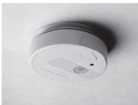
Fig. 35: Rivelatore di fumo
