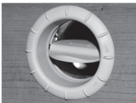
Fig. 77: Bocchetta dell'aria calda aperta
