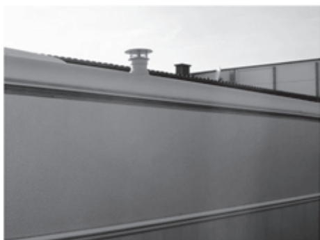
Fig. 78: Camino di scarico del riscaldamento a gas
