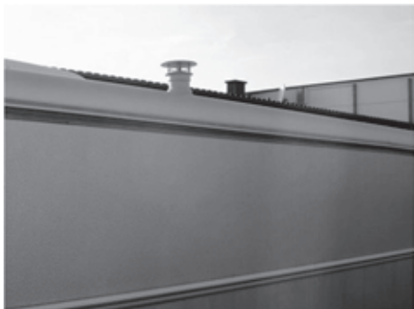
Fig. 78: Avgassrør for gassvarmen
