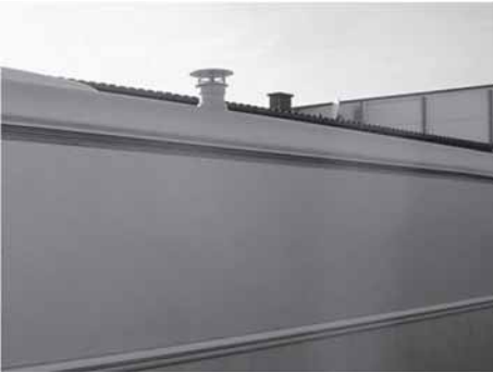
Abb. 74: Abgaskamin der Gasheizung
