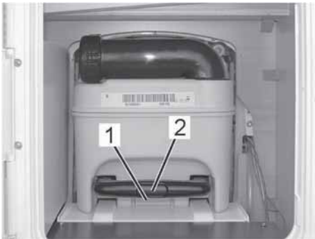
Abb. 123: Fäkalientank im Entsorgungsschacht
