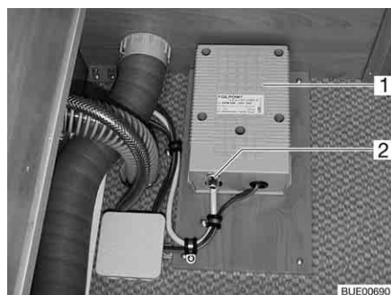
Bild 154 Trafo für elektrische Fußbodenerwärmung
