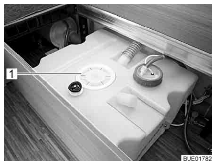
Fig. 207 Apertura per la pulizia sul serbatoio dell'acqua (esempio)
