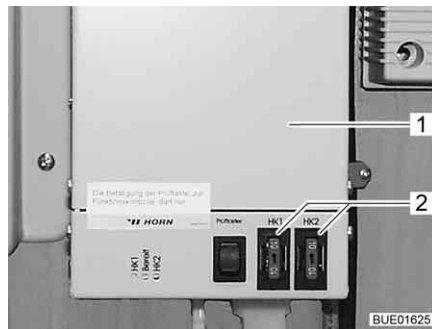
Bild 125 Regler Heizung für Abwasserleitungen
