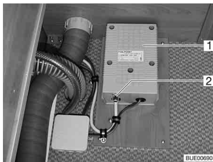
Bild 143 Transformator för elektrisk golvvärme
