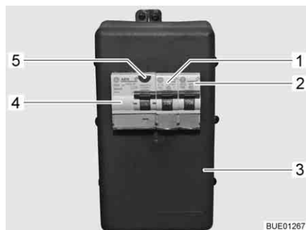
Bild 99 230 V-säkringslåda med ledningsskyddsbrytare och FI-brytare
