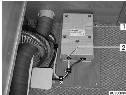
Bild 117 Transformator för elektrisk golvvärme
