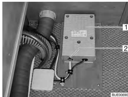
Fig. 123 Trasformatore per riscaldamento elettrico del pavimento
