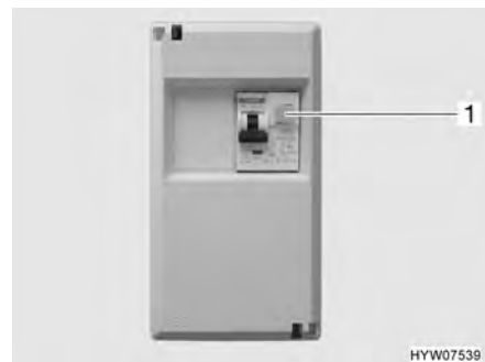
Afb. 105 230-V-zekeringenkast met leiding- en aardlekschakelaar (FI)
