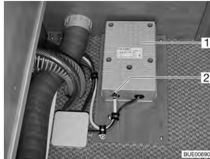
Afb. 124 Transformator voor de elektrische vloerverwarming
