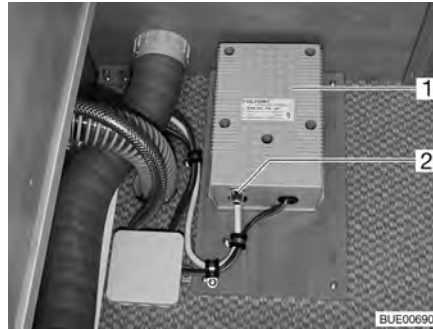
Fig. 124 Transformador para calentamiento eléctrico del piso
